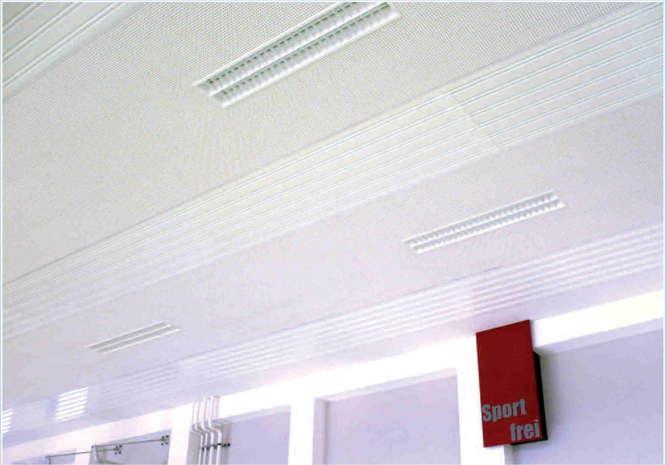
Einsatzbeispiel: Sporthalle Uetze
