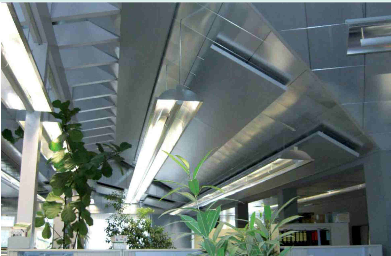
Einsatzbeispiel: Büros bei Deckel-Maho, Pfronten
